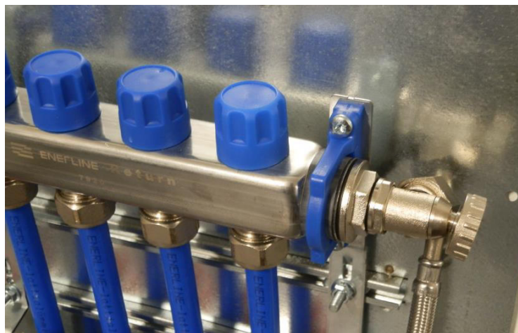
Ilmauspäädyn venttiilin avaaminen.
